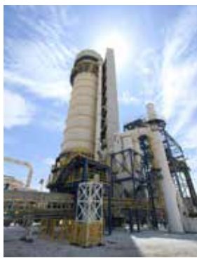
Coya Sur Plant.
